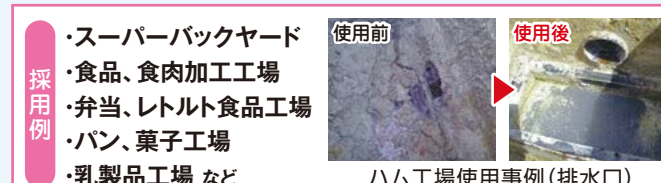
ハム工場使用事例(排水口)
