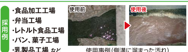
使用事例(側溝に溜まった汚れ)
