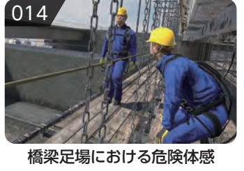
橋梁足場における危険体感
