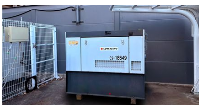
バイオディーゼル燃料を使用した発電機
