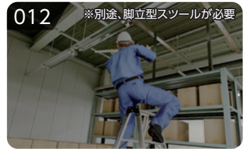
脚立作業の危険性
