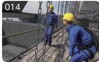
橋梁足場における危険体験
